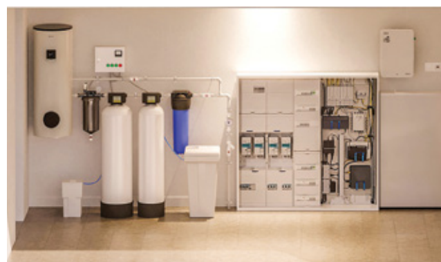
Das Herz jedes Hauses „der moderne Technikraum“
